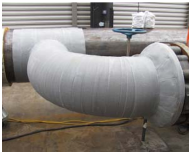
Tuberías de torres de enfriamiento, bases de tanques y tuberías bajo aislamiento térmico.
